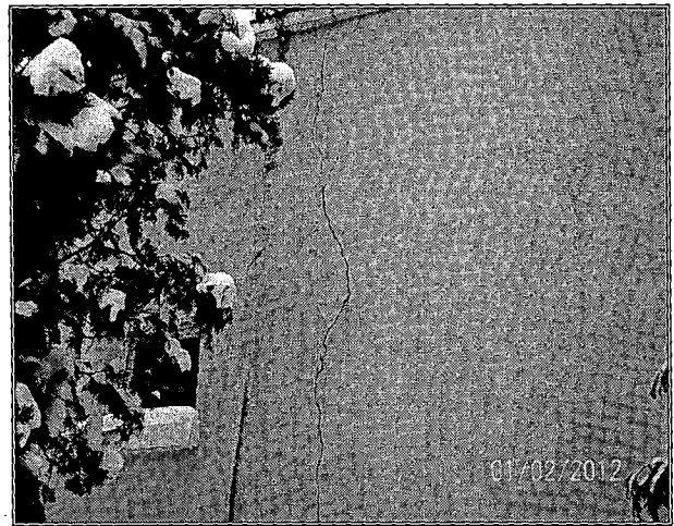
Foto 4 – Detaliu – crăpături structură rezistență
